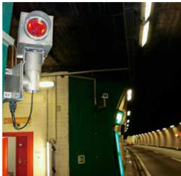
Ein Radar-Blitzgerät in einem Tunnel.
