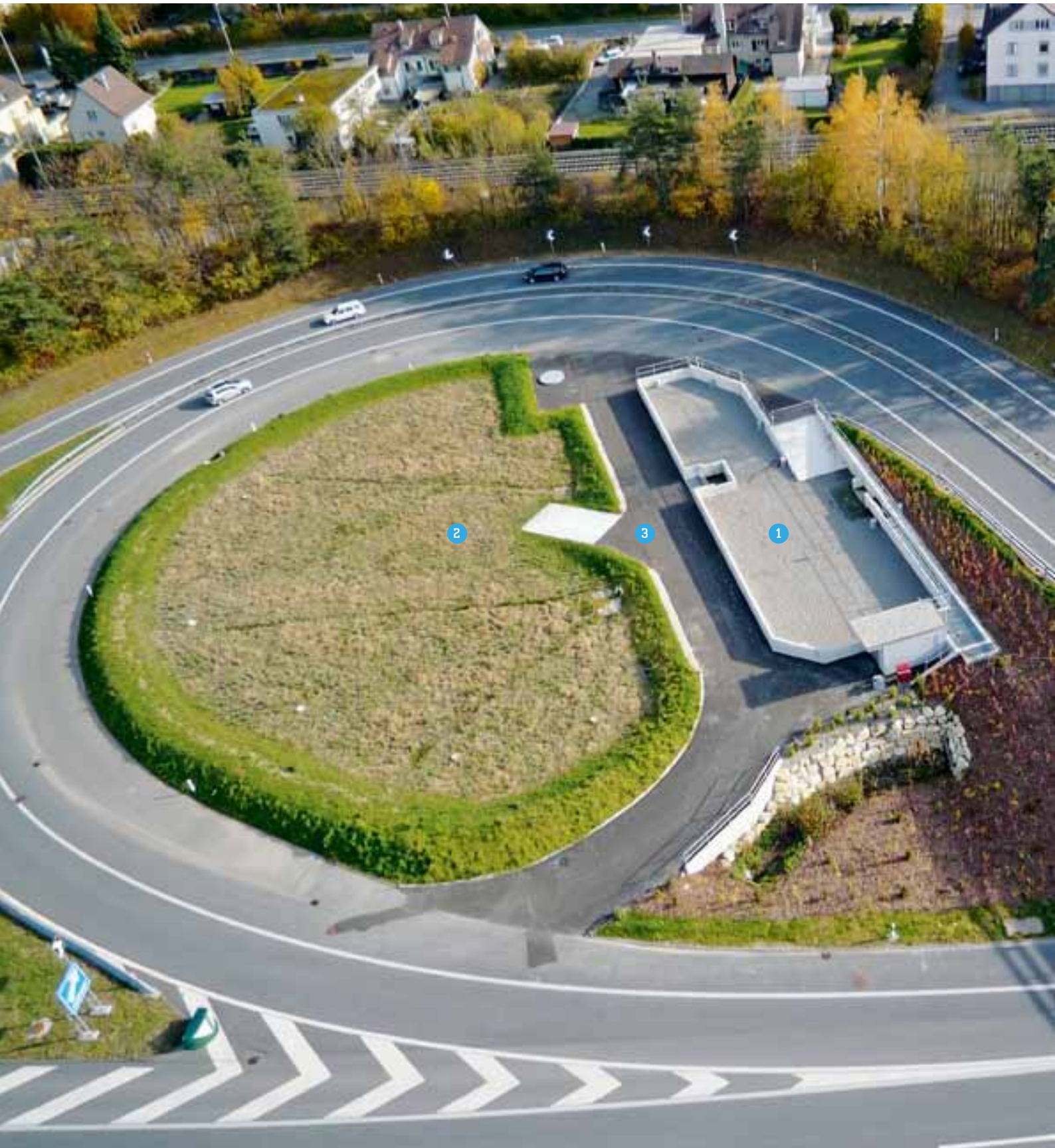
Die Strassenabwasser-Behandlungsanlage (SABA) mit Bodenfilter in Hallmatt bei Niederwangen BE: Nach der Vorbehandlung durch den Splittfilter (1) fliesst das Strassenabwasser zur Hauptbehandlung durch den Bodenfilter (2). Anschliessend versickert das zweistufig behandelte Strassenabwasser via Sickergalerie (3, unsichtbar) ins Grundwasser.
