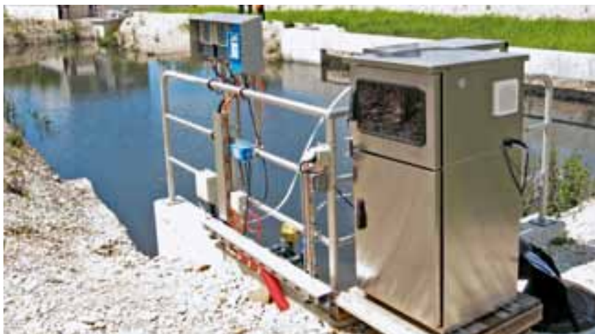
Die technische Installation einer SABA.
